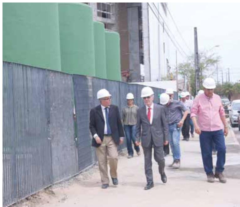
Implantação da primeira Estação de Tratamento de Efluentes do Fórum Desembargador Rodolfo Aureliano
